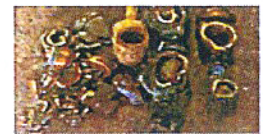
解体後 砲金バルブ
